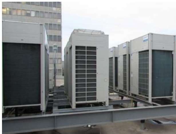
空調室外機フィン清掃
